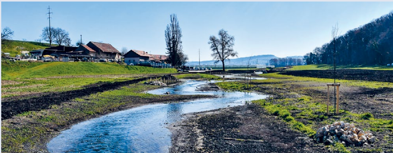
Dopo essere stato liberato dal cemento, il Bey ai piedi della collina di Chamblon ha aumentato di quattro volte il suo letto. (Foto: Romande Energie)
