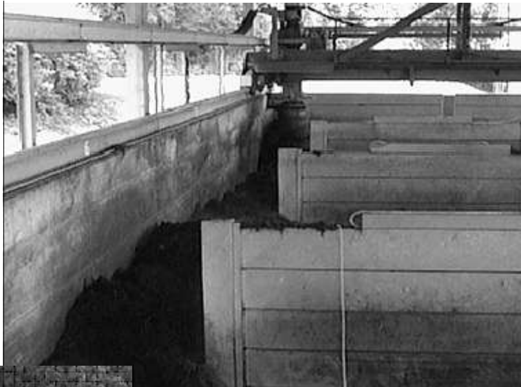
Abb. 8 (oben r.): Intensivrotte in belüfteten, überdeckten Boxen. Das Umsetzgerät hängt an einem Träger, der auf seitlichen Schienen fährt, und ist auf dieser Aufnahme in der hinteren Ecke positioniert (oben, Zentrum).
